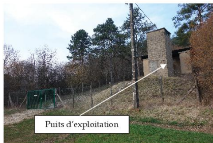
Puits d'exploration pour accéder à la galerie au sein du bosquet (vue vers l'Ouest)
